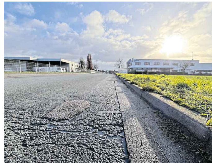
Gezeichnet durch viel Lkw-Verkehr: Die Stadt Versmold wird die Straße Im Industriegelände deshalb sanieren lassen.
