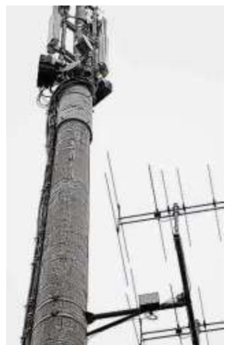
Sorgt für Versmolds Internet: Der Mast in der Gartenstraße.
